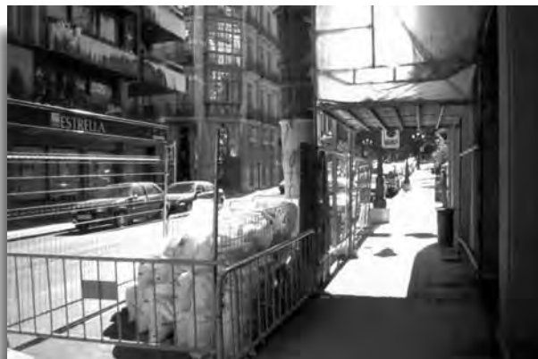
La zona de acopios y escombros se realiza en la calzada, dejando todo el ancho libre de la acera.
